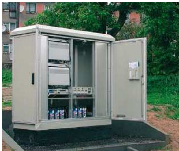
Rysunek 67: Zewnętrzna szafa telekomunikacyjna
